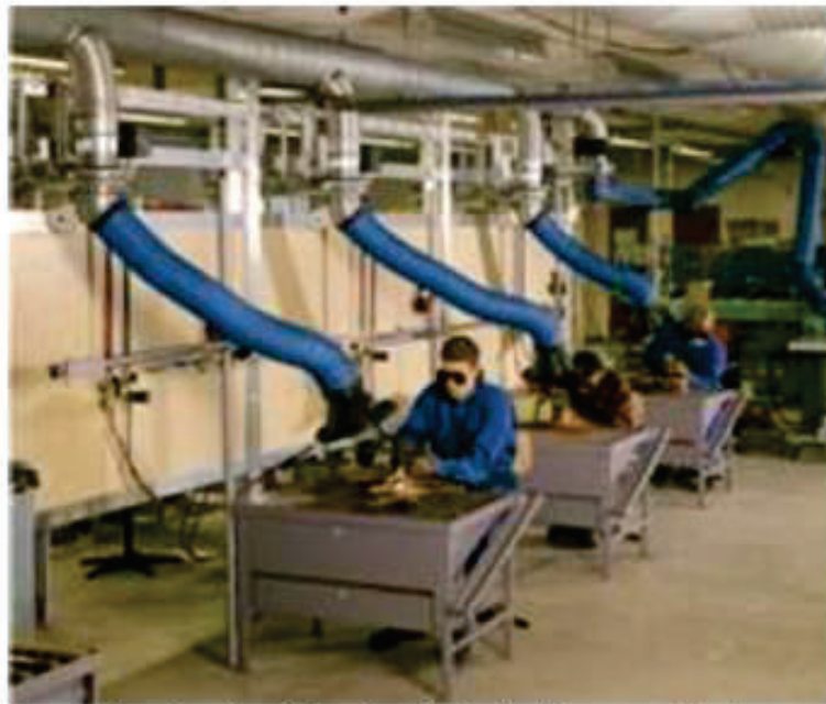
Fig. 4 – Ambiente de trabalho ventilado e com sistema de exaustão.
