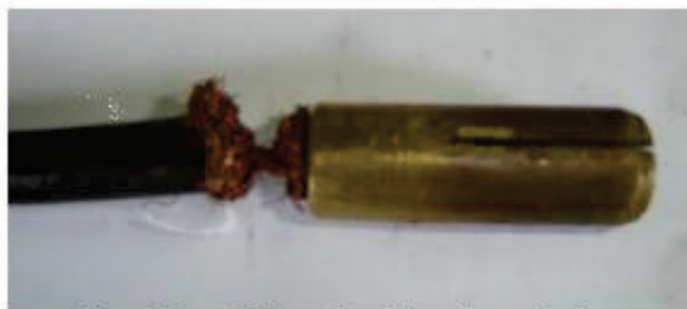
Fig. 38 – Cabo danificado próximo Ao conector
